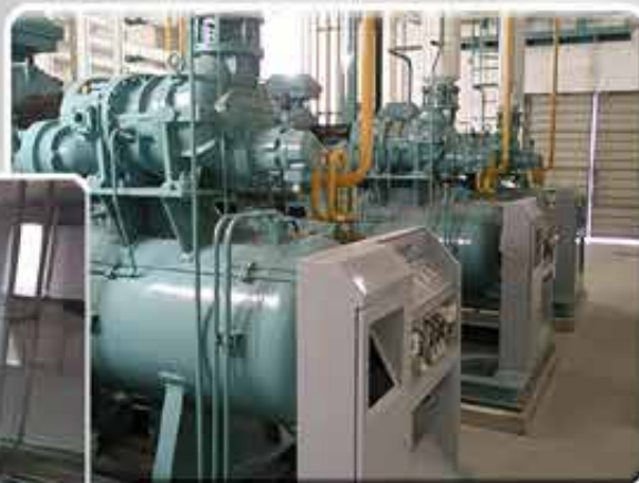
Sala de Maquinas
